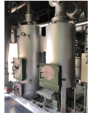
(株)匠工芸のバイオマスボイラー
