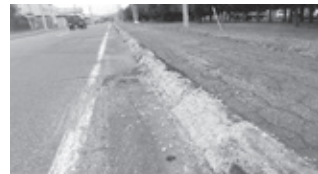
劣化が激しい道路縁石
